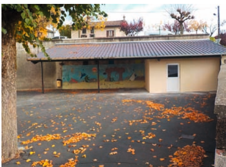
Rénovation des WC extérieurs (tous les travaux réalisés ont été effectués dans un bref délai par des entreprises Vézacoises).
