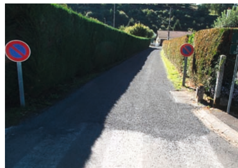
Réfection de voiries : Route de Combelles, impasse de la Cère, Rue du Stade.
